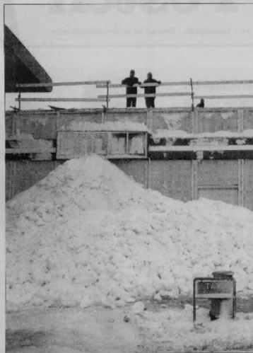
Ingen kom til skade, da dele af Bilkas tag i Tilst ved Århus styrtede sammen natten til søndag. Foto: Casper Dahlhoff
